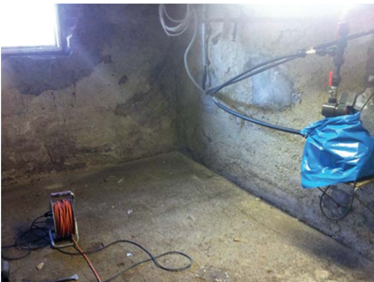
In diesem Keller bröselte der Putz von der Wand, die Luftfeuchtigkeit war hoch und der Keller nicht nutzbar.
