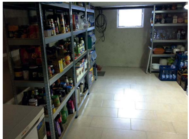
Aufsteigende Feuchtigkeit stellte sich als Ursache heraus - Genial Feuchteregulierungsputz war die Lösung.
