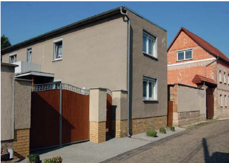
Einfamilienhaus vor der Neugestaltung im Jahre 2008. Sichtbare Putzschäden beunruhigten den Hausbesitzer.
